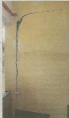
Kesan keretakan di Blok F Pangsapuri Taman Keramat Permai.
