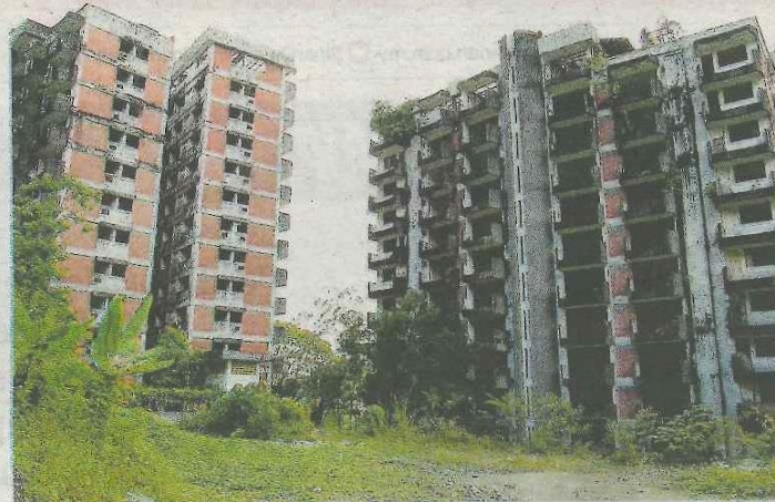
Dua blok kondominium Highland Towers yang usang dan tidak dijaga.
