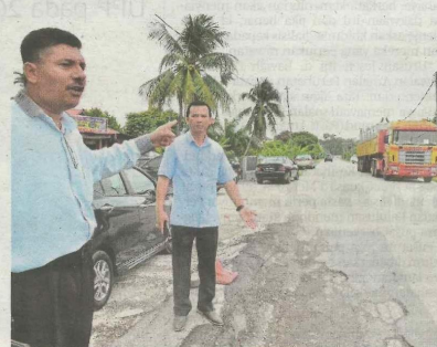
S Hassan Kuthoos (kiri) dan Bahar menunjukkan keadaan jalan raya yang rosak serta berlompok kesan kenderaan berat yang melalui Jalan Paip Kampung Budiman, Meru.
