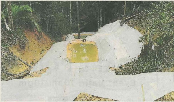
■工地现场也设有泥水滤水器（Silt Trap），有助于排水。
