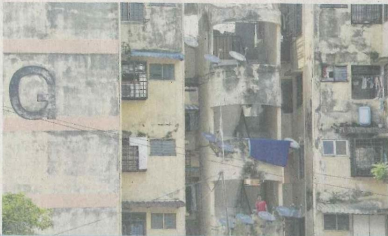
KEGAGALAN pihak berkuasa tempatan menjalankan kerja-kerja penyelenggaraan menyebabkan penduduk hidup dalam keadaan tidak selesa.
